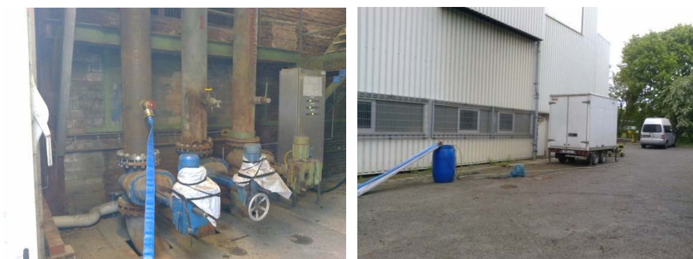
Abbildung 49: Grubenwassermessstellen und Zentrifugenprobenahme Zeche Concordia, Fotos LANUV
