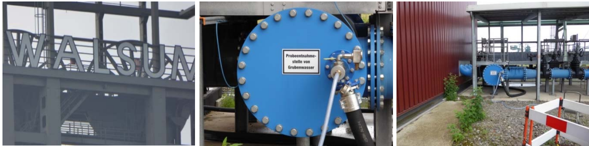
Abbildung 25: Grubenwassermessstelle Duisburg Walsum, Druckrohr
